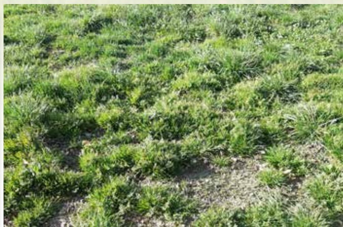
Photo 4 : trous dans la couche végétale
